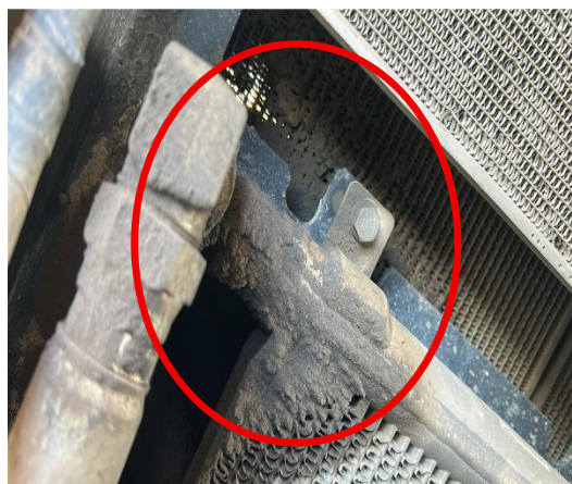
Gambar 3. Fin radiator yang mengalami kebuntuan dan kebocoran pada oil cooler
